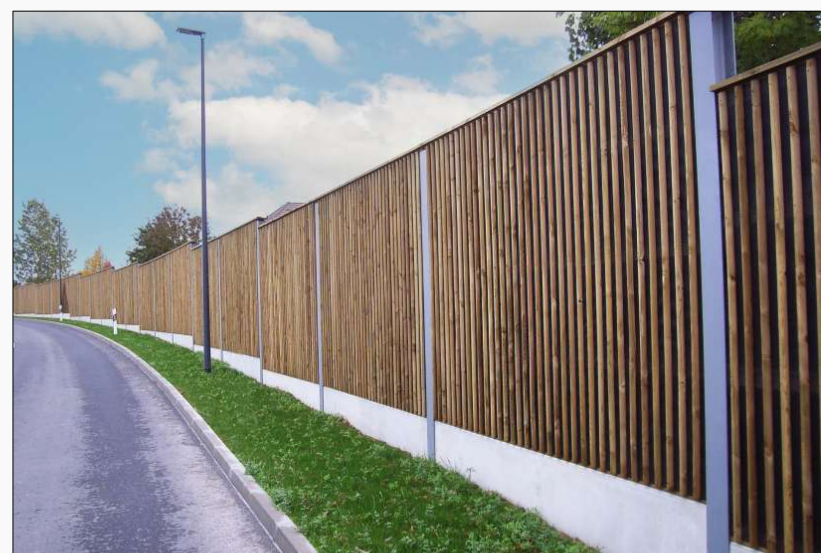
Figure 2: Mur antibruit en bois
